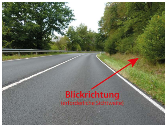
» Abb. 18 Bei einem Bestandsaudit festgestelltes Kerndefizit „unzureichende Haltesichtweite“
